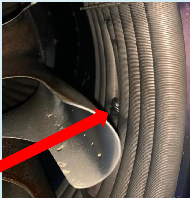
Detail poškození předchladiče
